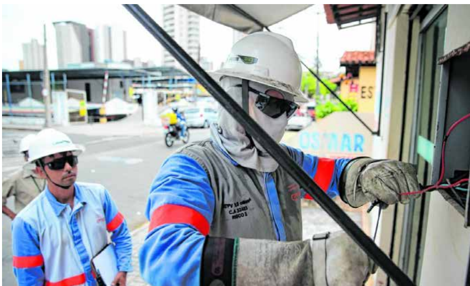
A prestação de serviços de distribuição de energia elétrica, em Goiás, continua abaixo da crítica, segundo a ANEEL
