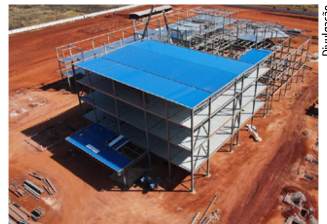
Fundações, lajes e armações da ala infantil do Complexo Oncológico de Referência de Goiás (Cora) foram finalizadas
