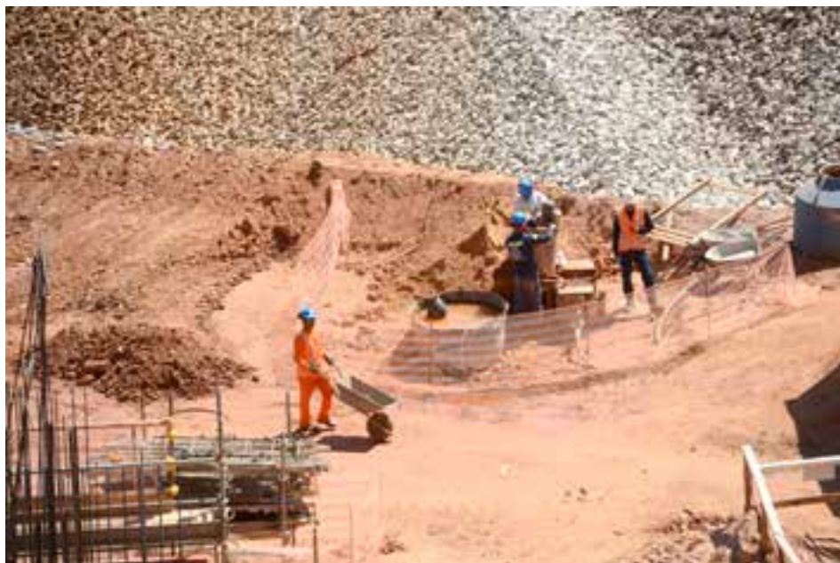
Trabalhadores na obra do muro de contenção construído para eventual rompimento da Barragem B3/B4
