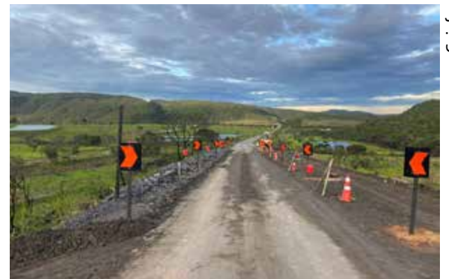
Trecho da GO-118 é liberado para veículos pesados, no sistema pare e siga, com sinalização e iluminação reforçadas
